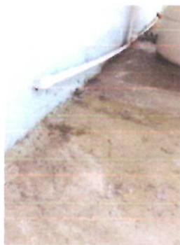
IMPERMIABILIZACIÓN DE LOSA POR FILTRACIÓN DE HUMEDAD
