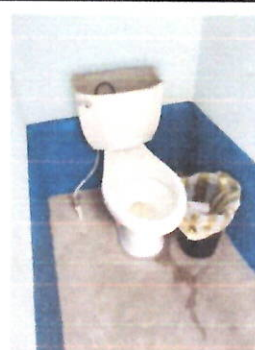
SUSTITUCIÓN DE SERVICIOS SANITARIOS, EN MAL ESTADO
