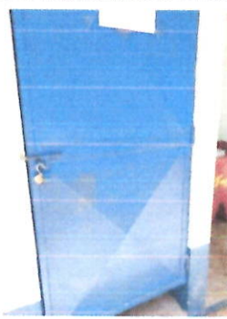
PUERTA, MANTENIMIENTO DE PUERTA SANITARIOS EN MAL ESTADO
